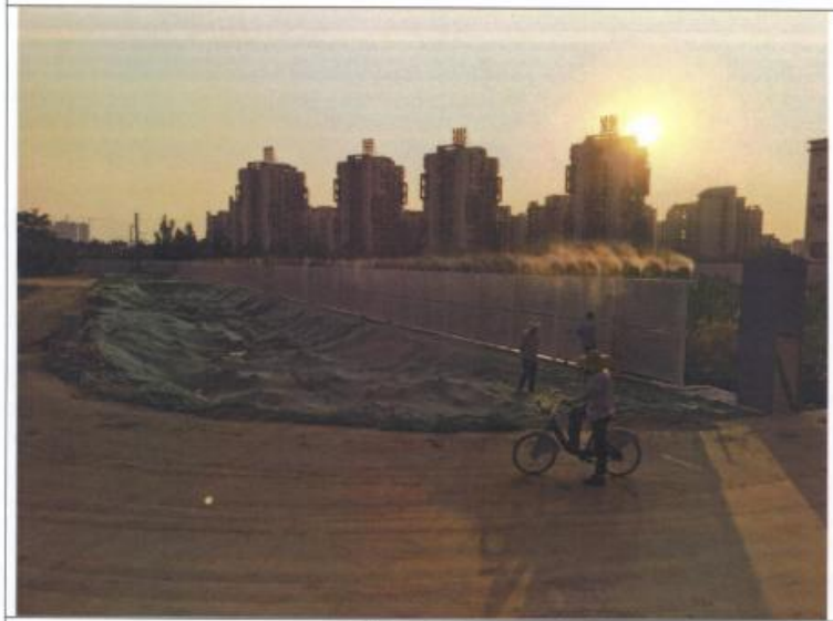
围墙喷淋系统照片
