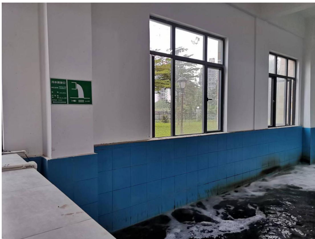
图 3-8 项目污水排放口照片
